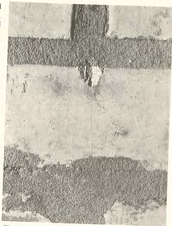
Fig. 23. Midte af Molersten i Pille opmuret i Cementmørtel. Som Følge af Trykket fra Stødfugerne er Stenen revnet og afskallet. Pille var opmuret af lufttørre Sten.
